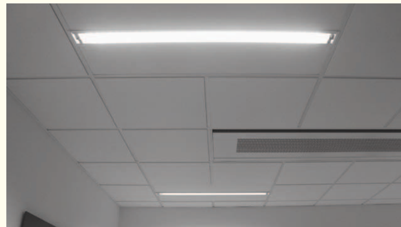
Lysrørsarmatur og downlight, eksempler
