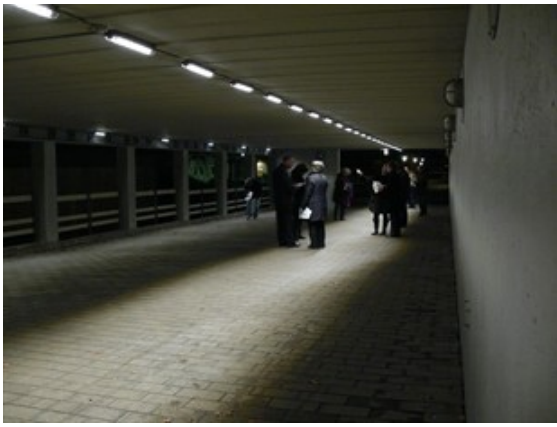
Prøvebelysning: Tunnelbelysning med LED i Albertslund Kommune. Foto: Steen Traberg-Borup.
