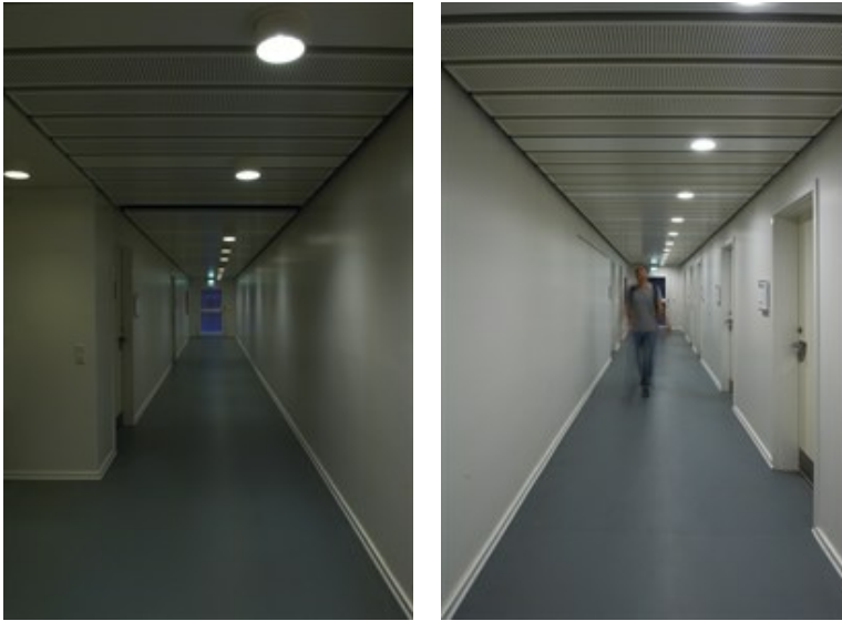
Gangbelysning før (tv) og efter (th) installation af ny og mere energieffektiv belysning. Foto: Thorn.
