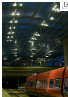
Belysning med downlights på Flintholm Station i København. Foto: Silla Herbst.
